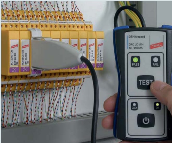
Überprüfung eines Ableiter-Moduls mit einem Handprüfgerät basierend auf RFID-Technik.
