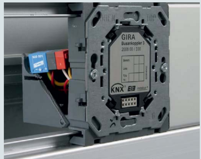
Schutz eines KNX-Busankopplers mit dem BUSector. Installation an einer Busklemme im Montageaum eines Kabelkanals.
