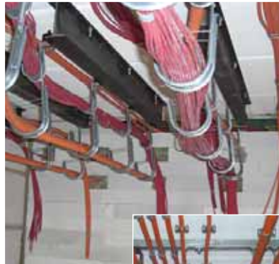
Installationen in der Feuerkammer.
