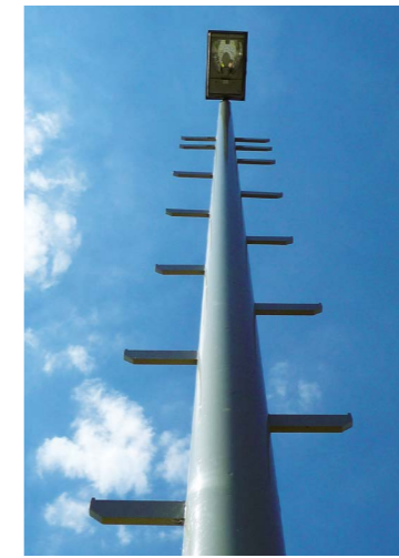
Besteigbarer GFK-Mast mit Aufsatzleuchte am Bahnhof Schönenerweide in Berlin
