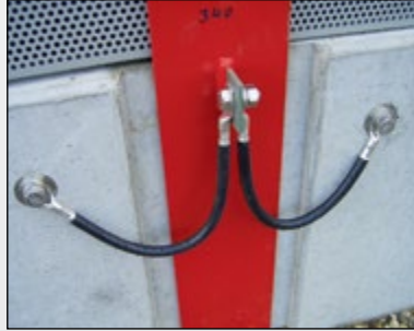
Erdungsverbinder an Lärmschutzwänden
