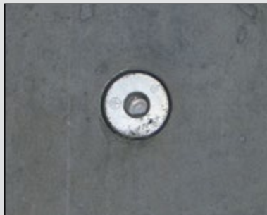
WEB 12 mit O-Ring an der Tunnelwand
