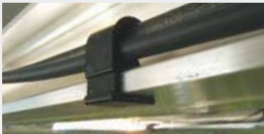
Kabelführung bzw. Kabelkanal
