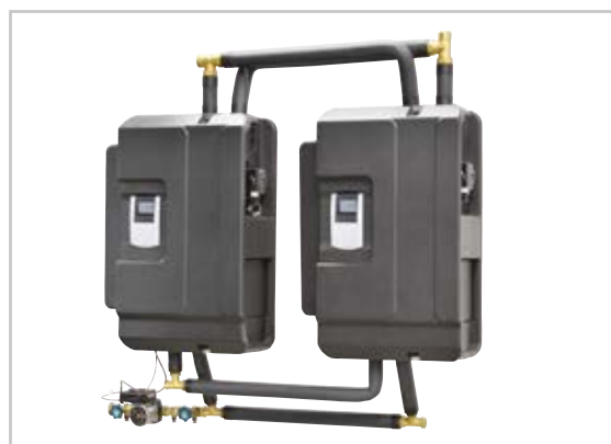
Frischwasserstation Kaskade inkl. Zirkulationspumpe
