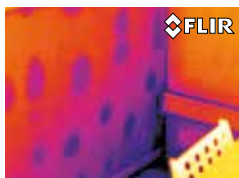
Das Wärmebild zeigt die Klebestellen von Rigipsplatten.
