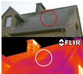
Mit Hilfe der Thermografieinspektion wird eine fehlende Dämmung im Dach erkannt. Diese kann jetzt repariert und weitere Energieverluste vermieden werden.
