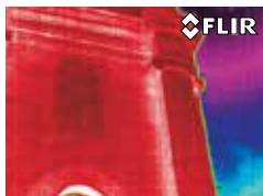
Das Wärmebild zeigt eine verborgene Fensterkonstruktion, die für das menschliche Auge nicht sichtbar ist.
