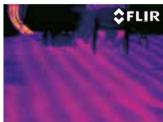
Undichte Stellen in einem unterirdisch verlegten Fernwärmenetz.
