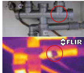
Die Verstopfung in dieser Rohrleitung ist mit Hilfe einer Wärmebildkamera schnell lokalisiert. Maßnahmen können ergriffen werden, bevor sich das Problem ausweitet.
