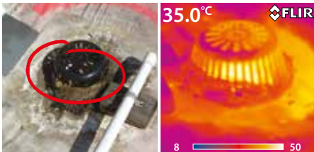
Das Wärmebild zeigt Wasserlecks im Flachdach.
