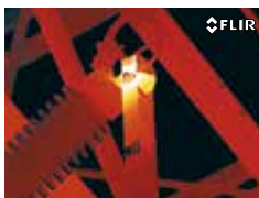
Fehlerhaft befestigte Verbindung
