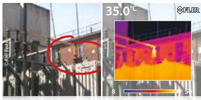
Inspektion des Transformators mit der Bild-in-Bild-Funktion.
