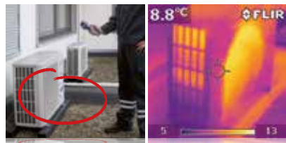
Schnelle und mühelose Überprüfung einer Klimaanlage.
