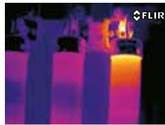
Innere Beschädigung einer Sicherung
