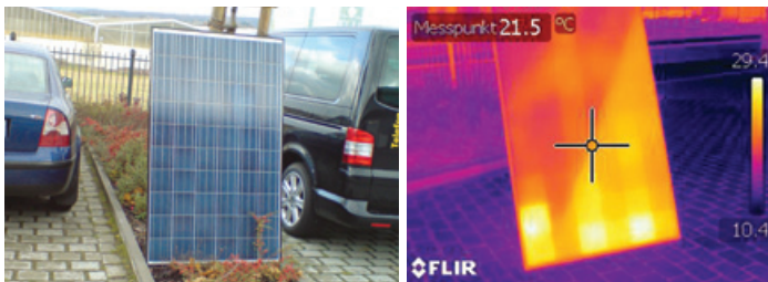
Ein Test mit einem Solarmodul zeigt, dass die heißen Stellen sogar von vorne mühelos auf dem Wärmebild zu erkennen sind.
